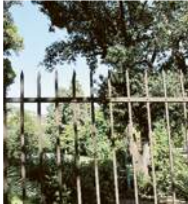
LA RECINZIONE Bassa e facilmente scavalcabile da parte dei malintenzionati
