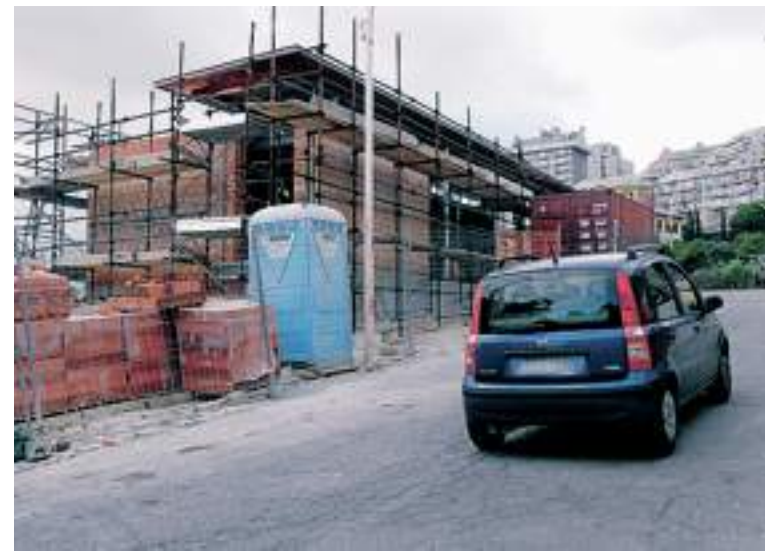
Il cantiere aperto in via Romana di Quarto, al centro delle polemiche
